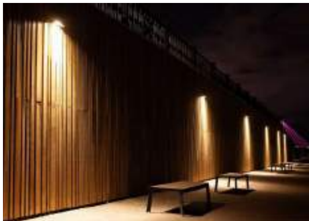
Илл. 4.1.14. ОБОРУДОВАНИЕ ДЛЯ ОСВЕЩЕНИЯ ПОДПОРНЫХ СТЕНОК
