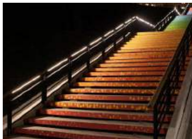
Илл. 4.1.18. ОБОРУДОВАНИЕ ДЛЯ ОСВЕЩЕНИЯ ОГРАЖДЕНИЙ И ЛЕСТНИЦ
